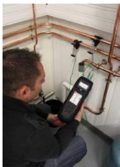
Pomiar temperatury Ciepłej Wody Użytkowej
